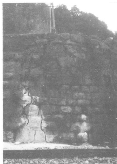
Slika 2. Večja razpoka v kamnitem zidu.
